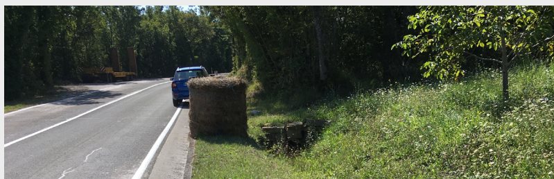
Système d'évacuation en béton non protégé
